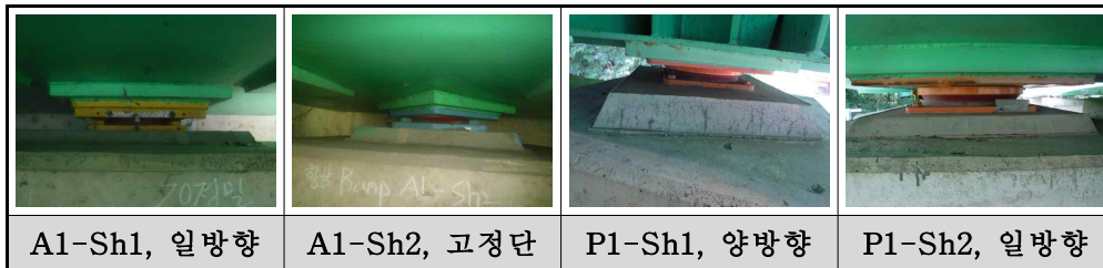
&lt;그림 3.3.9&gt; 상신육교(향남방향, 램프) 교량받침 현황
