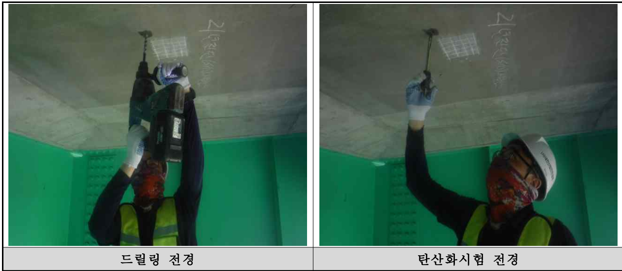
&lt;그림 3.4.6&gt; 상신육교(발안IC방향, 본선) 탄산화시험 전경
