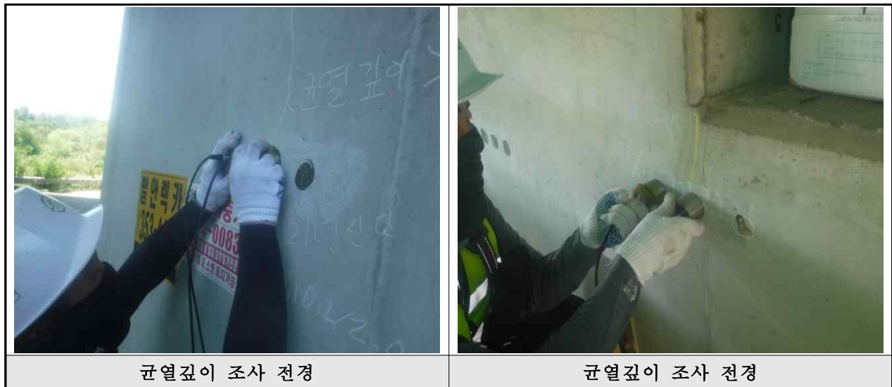
<그림 3.4.12> 상신육교(발안IC방향, 본선) 균열깊이 조사 전경
